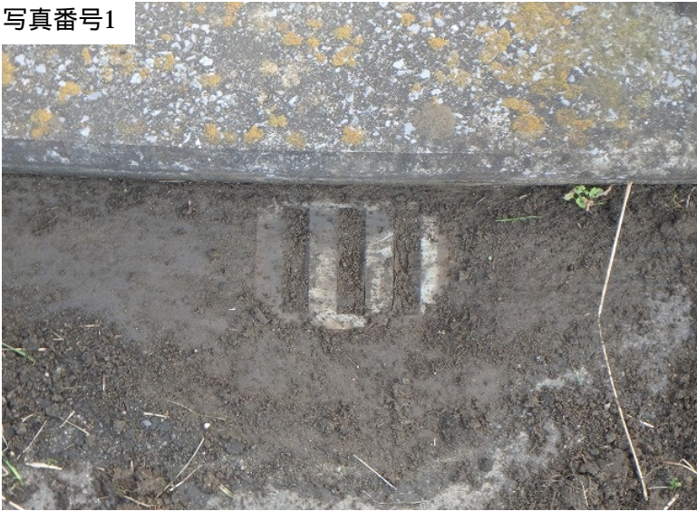
排水ますに土砂 詰りが見られる。
