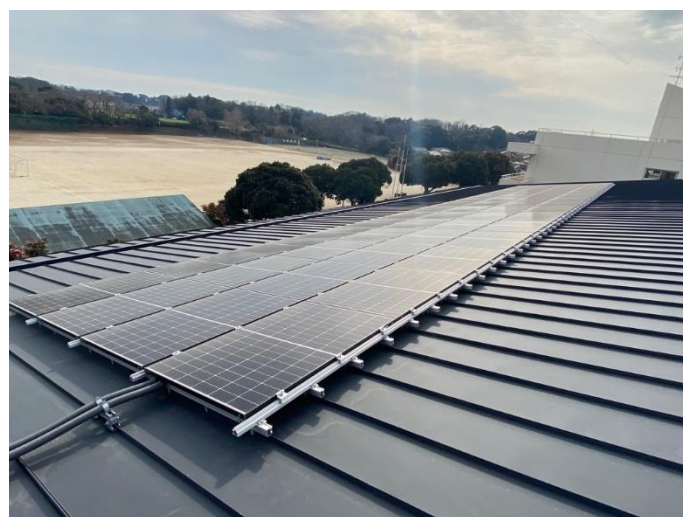
太陽光発電設備
