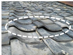
瓦に浮き上がりが生じている
