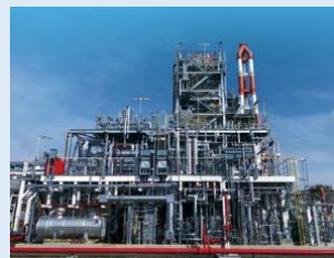
エタノールからエチレンを製造するパイロット設備
