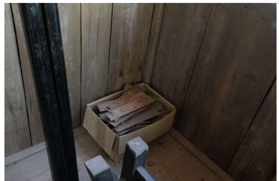
落下した屋根材
