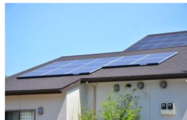
写真 太陽光発電システム
