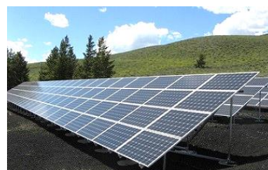
写真 事業用太陽光発電設備
