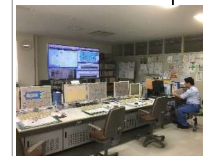
中央監視装置 (管理棟 2 階)
