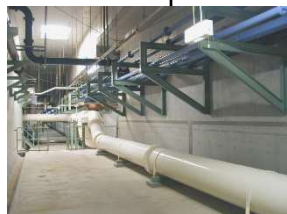
管廊 (水処理反応タンク下部)
