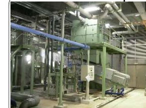
自動除塵機 (沈砂池フロア棟 B2 階)
