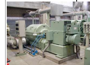
曝気フロア (沈砂池フロア棟 1 階)
