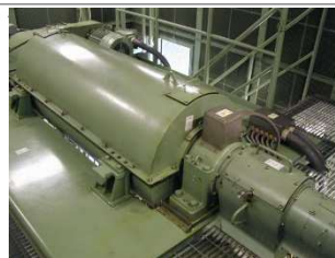
遠心濃縮機 (脱水機棟 2 階)
