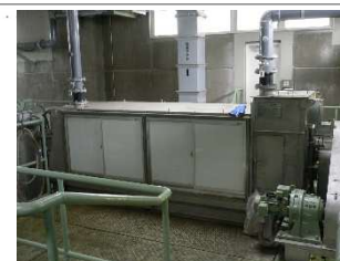
N01 脱水機 (脱水機棟 2 階)
