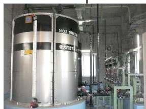
塩素注入設備 (次亜タンク棟)
