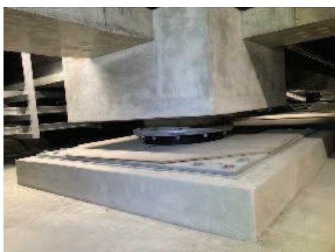
免震装置（北庁舎免震ピット）
