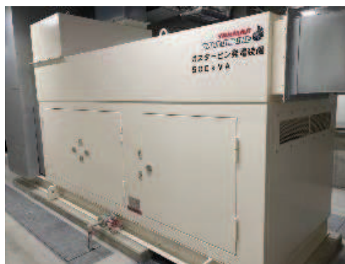
非常用発電機（設備棟2階）
