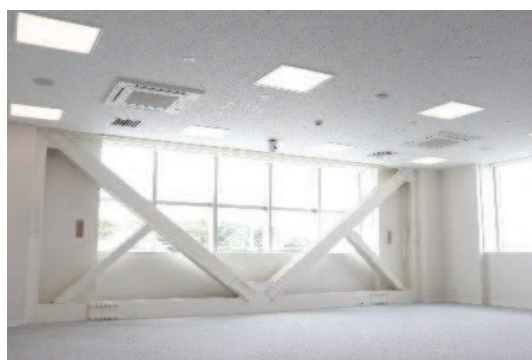
補強鉄骨ブレース（中庁舎4階）
