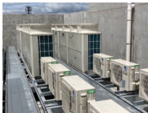
屋上に設置された高効率エアコン 室外機（北庁舎）
