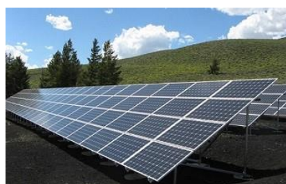
太陽光発電システム（事業用）
