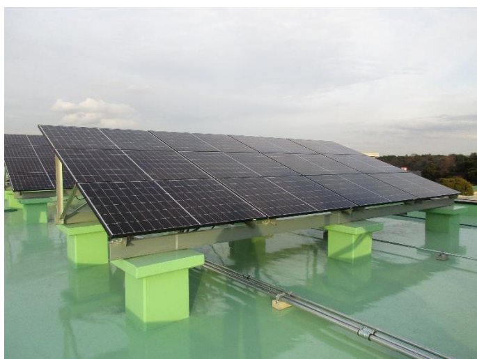
太陽光発電設備
