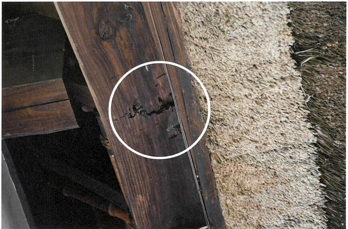
エー 2. 南東隅（軒）の割れ
