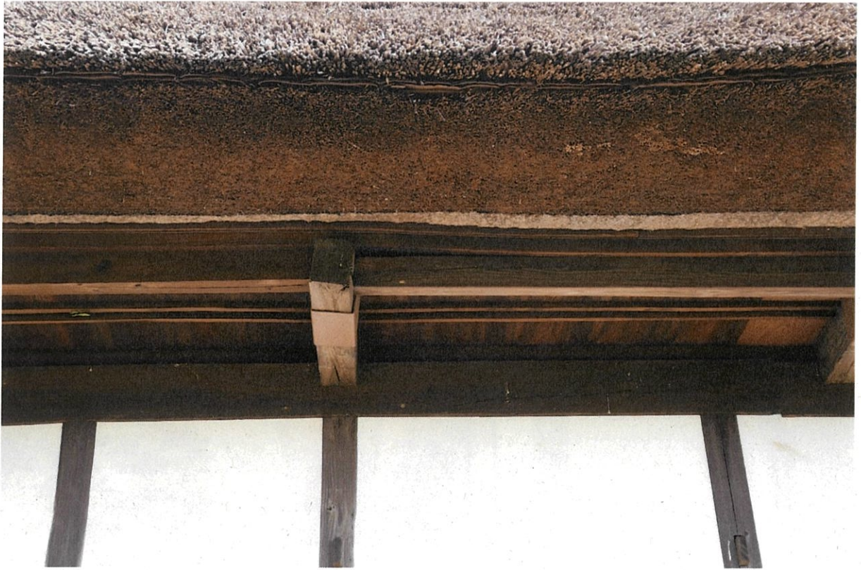
ウー 3. 南屋根の船柁（せがい）の割れ（鉄板固定）
