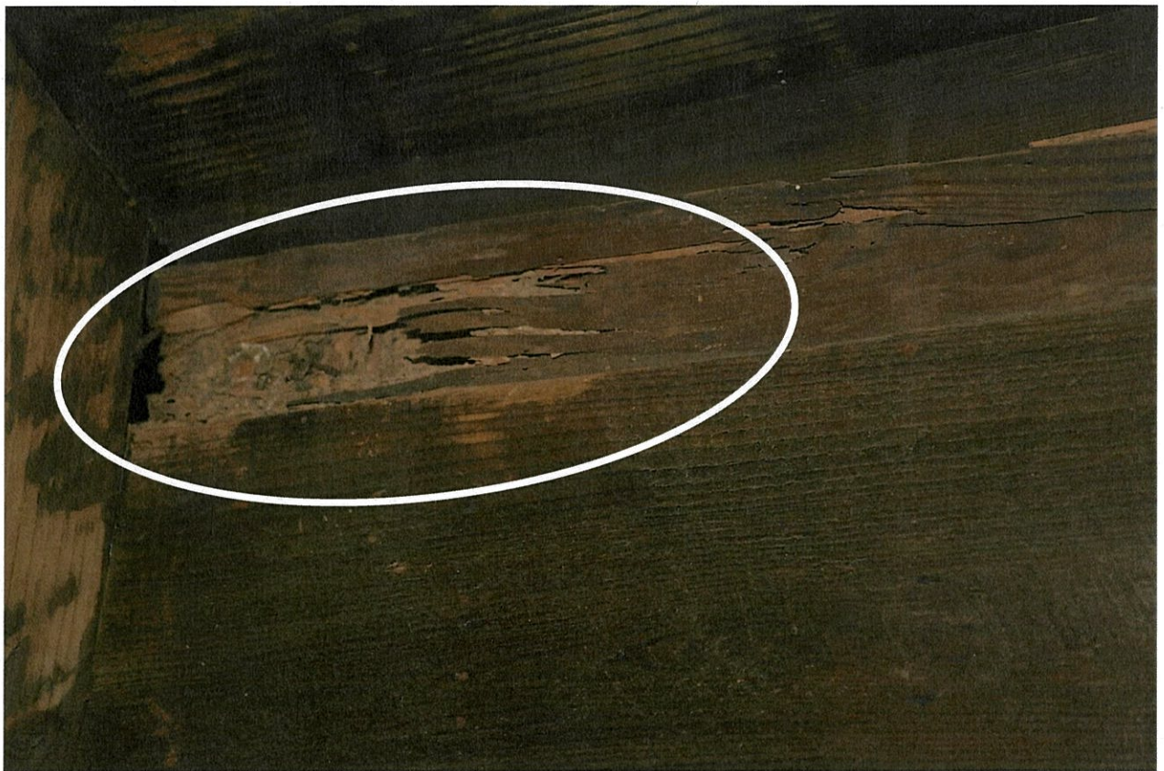
セー 2. オク 北側雨戸・障子戸袋内シロアリ被害
