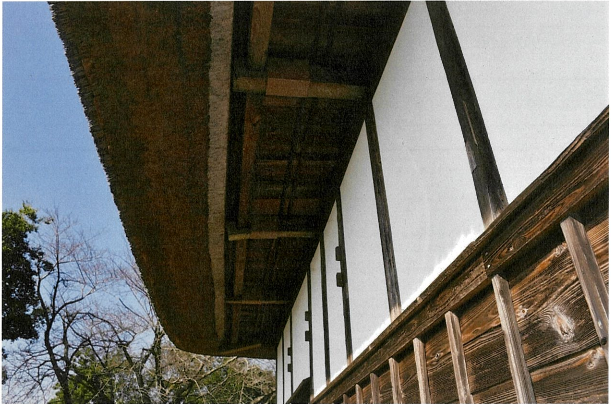
ウー 1. 南屋根の船桧（せがい）の割れ（鉄板固定）
