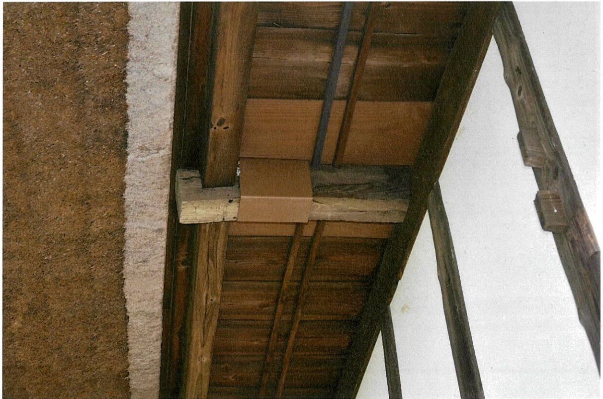
ウー 2. 南屋根の船桧（せがい）の割れ（鉄板固定）
