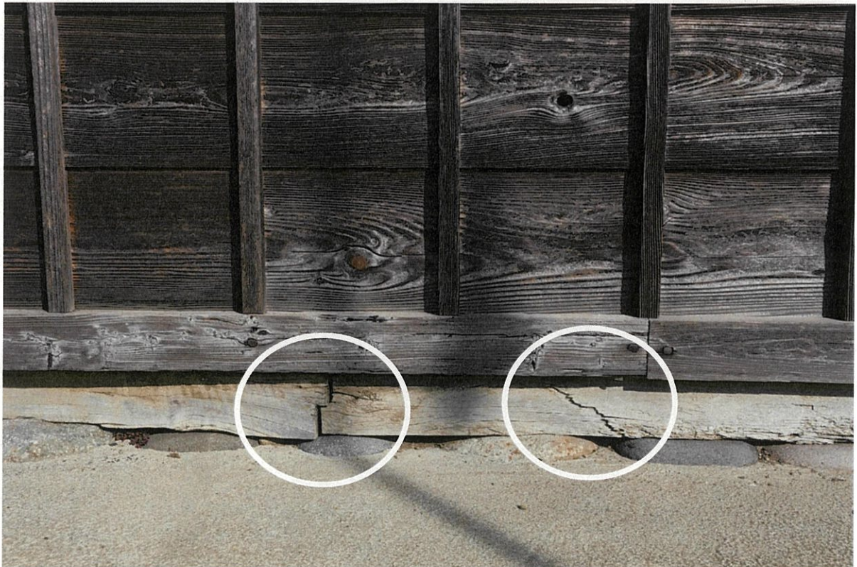
イ. 南（側）面礎石上の土台材の組み合わせズレ・割れ
