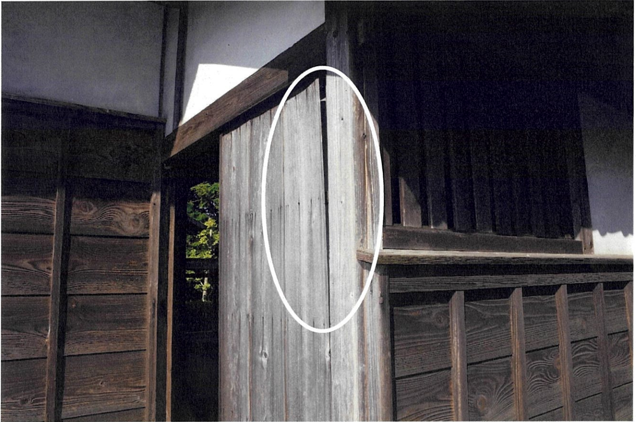
クー1. 東（裏）面 ユドノ引戸板材の反り（一部木ねじで補修）、板材下端部腐食
