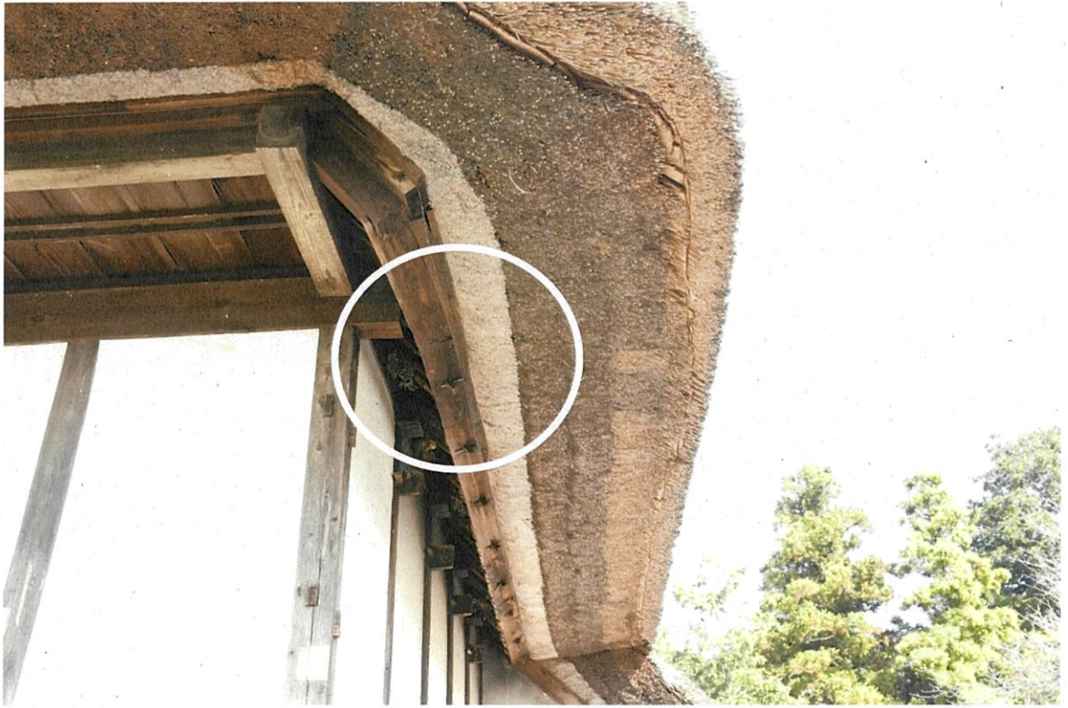
エー 1. 南東隅（軒）の割れ
