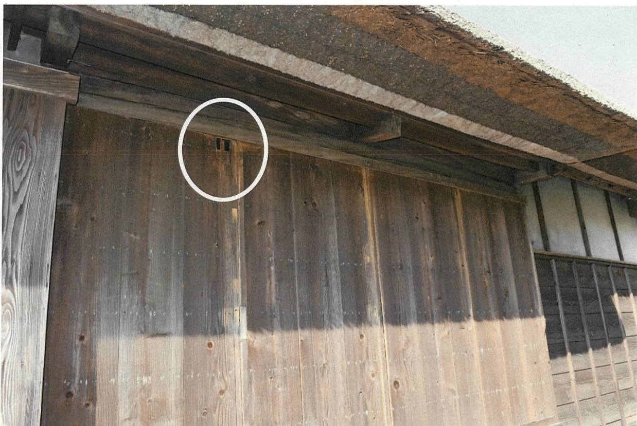
キー１．東（裏）面 ナカノマ雨戸欠損、板材の反り（反りにより戸袋に接触し、破損する。）
