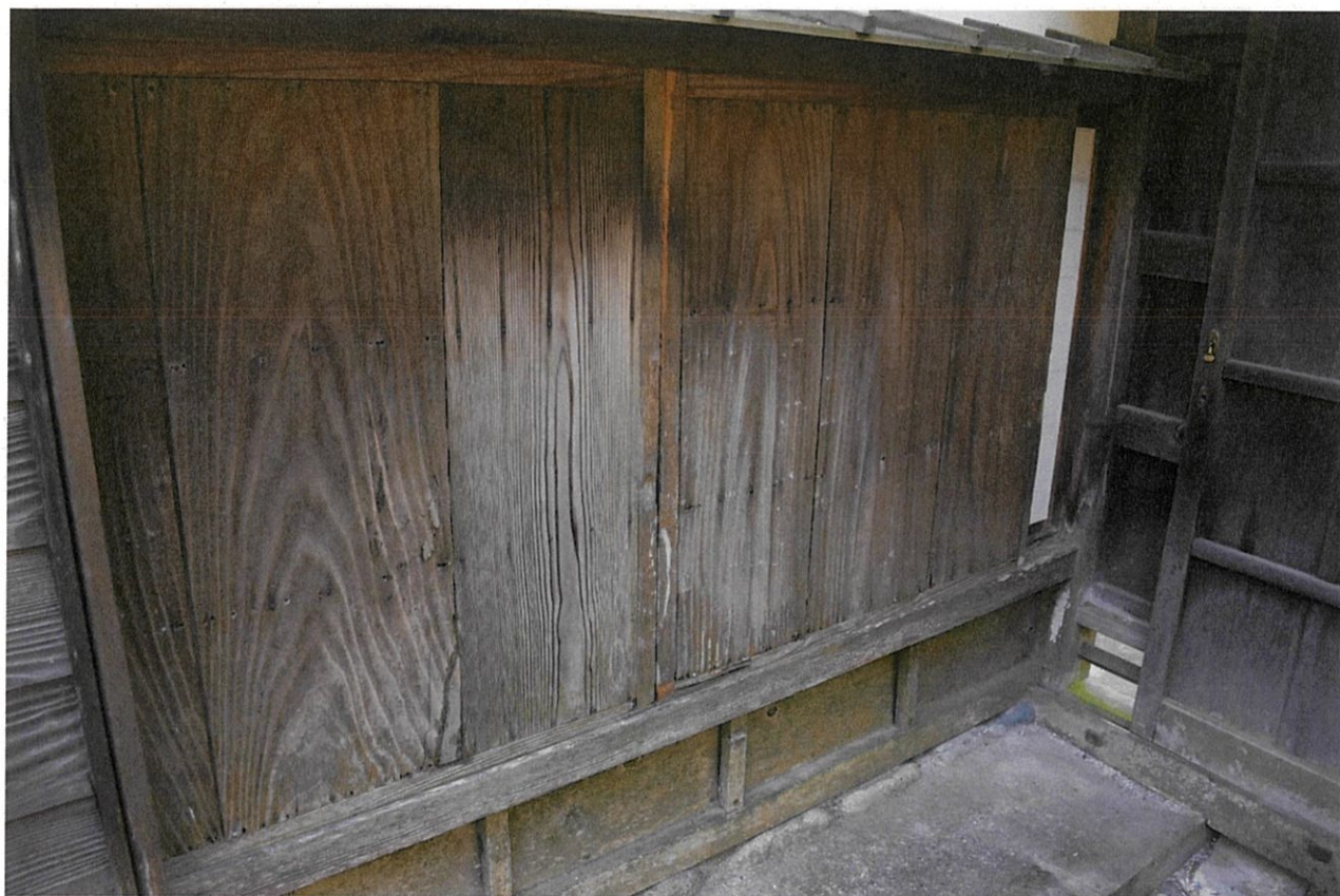
ケ. 北(側)面 ショイン、躰(にじ)り口雨戸板材の反り(一部木ねじで補修)
