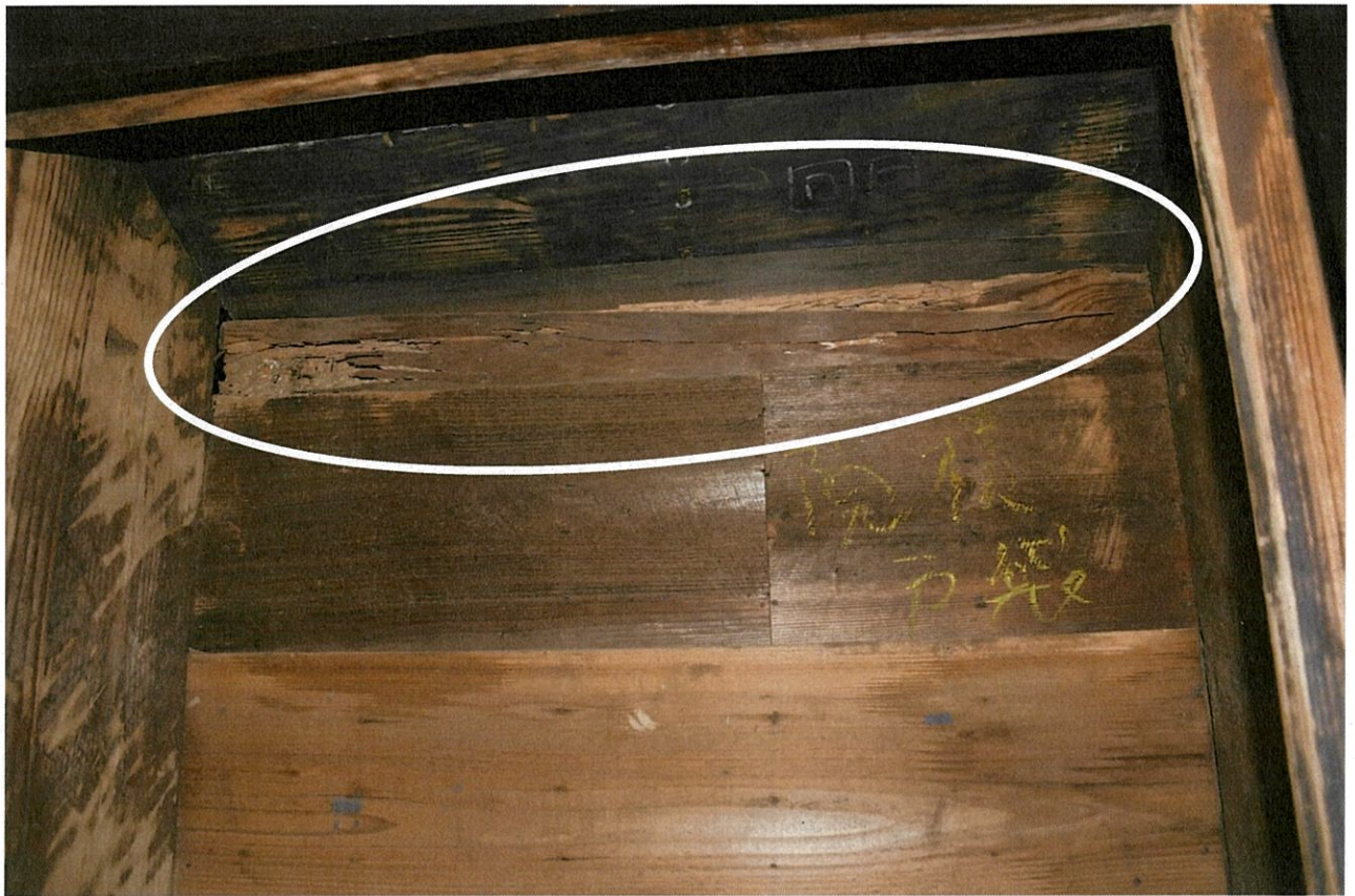
セー 1. オク 北側雨戸・障子戸袋内シロアリ被害
