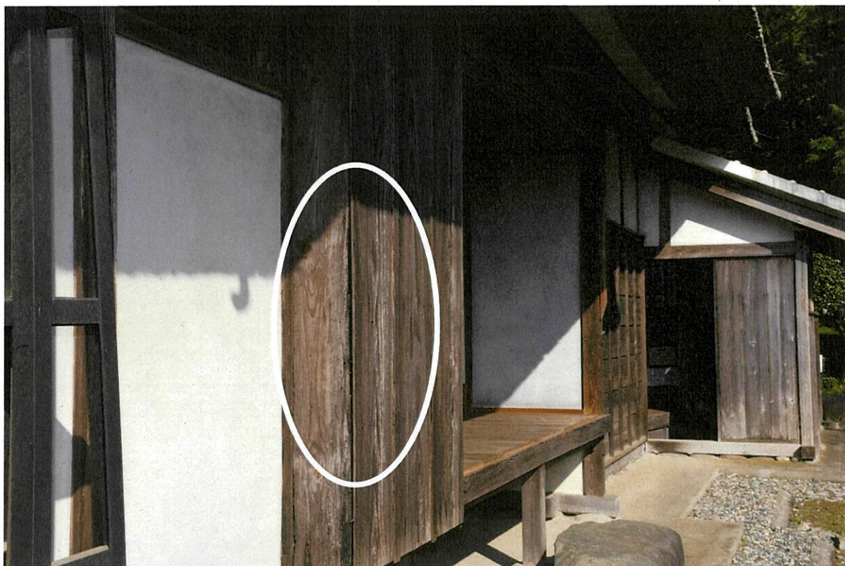
カー1. 東（裏）面 ナカノマ戸袋板材の反り
