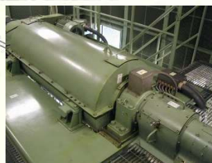
遠心濃縮機 (汚泥脱水機棟 2 階)
