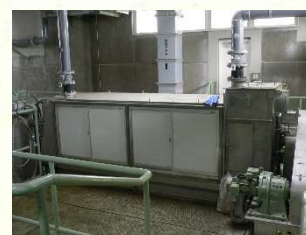
N01 脱水機 (汚泥脱水機棟 2 階)
