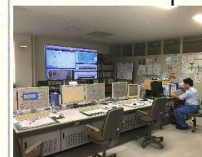
中央監視装置 (管理棟 2 階)
