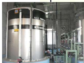
塩素注入設備
