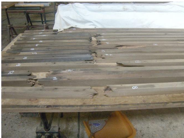
① 地垂木 破損状況
