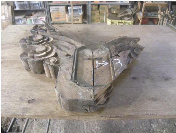
⑦ 鬼板 破損状況
