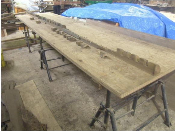
④ 木負 破損状況
