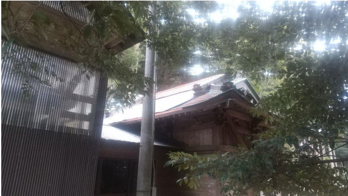
拝殿被害箇所（トタン部分が被害箇所）（北西→）
