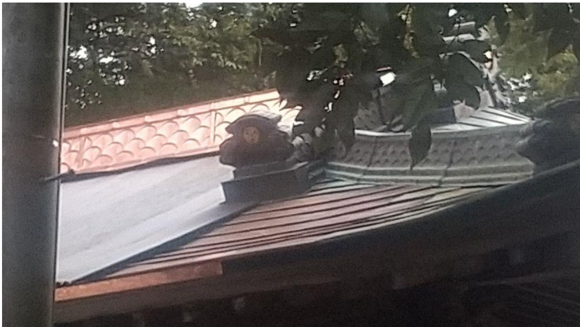
拝殿被害箇所近景（北西→）
