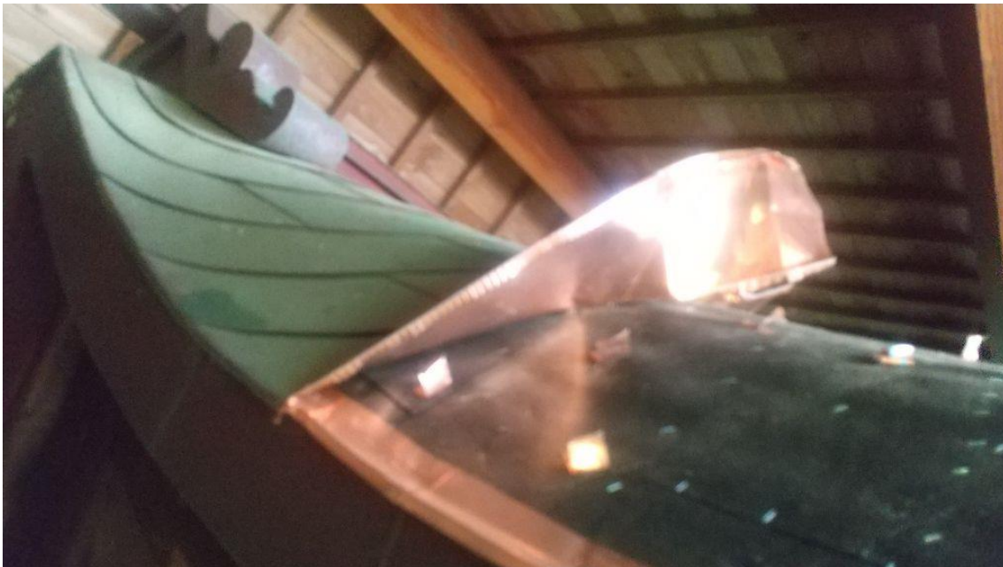
小高神社本殿被害写真②（覆屋内から）（南西→）
