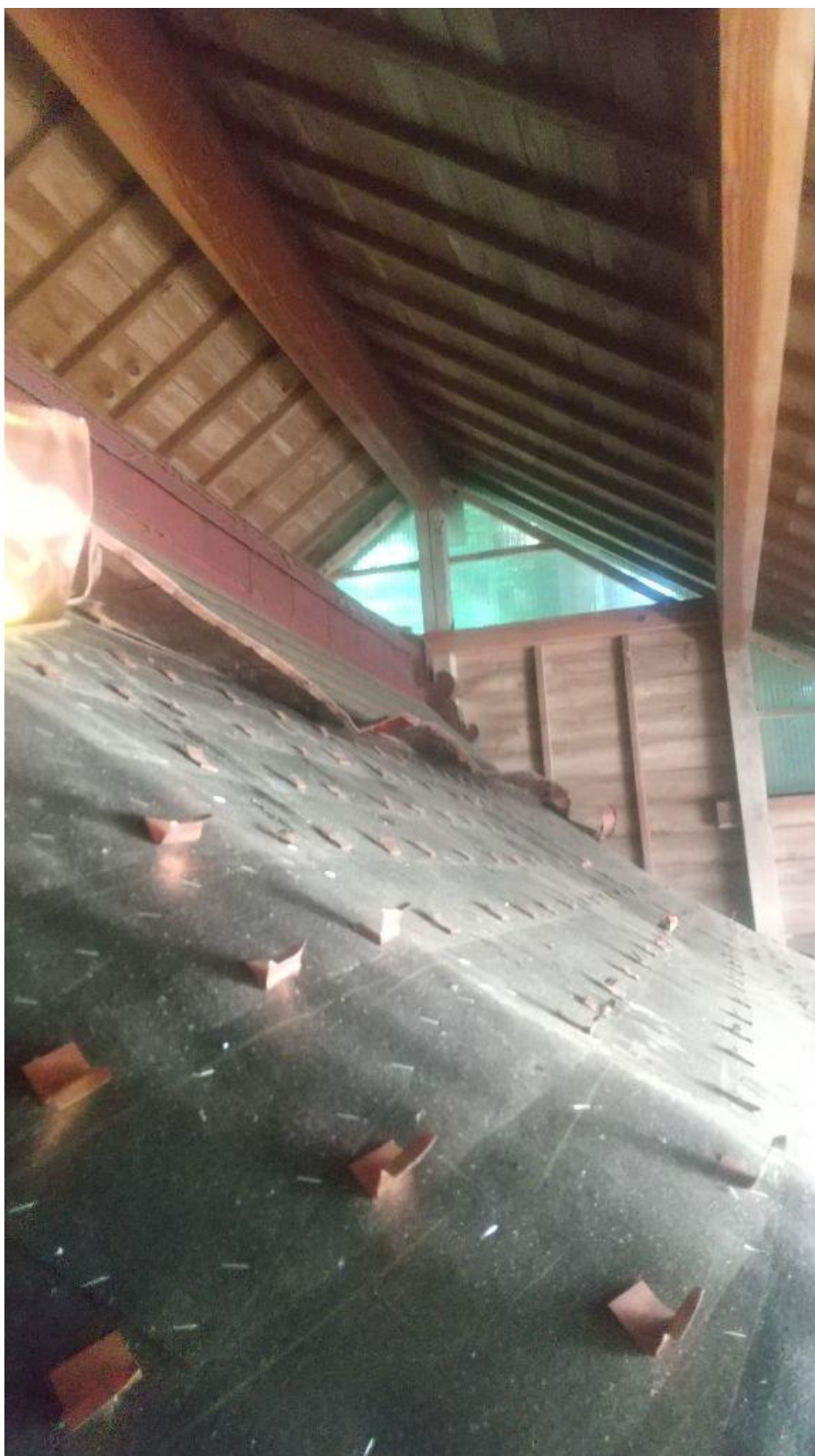
小高神社本殿被害写真③（覆屋内から）（南西→）
