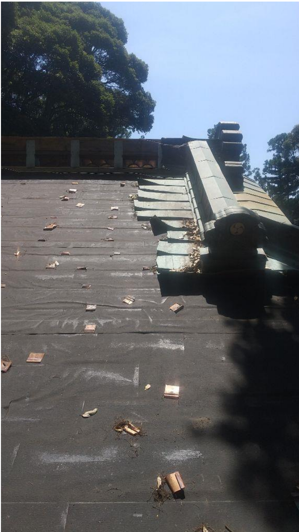
小高神社拝殿被害状況写真（北西→）
