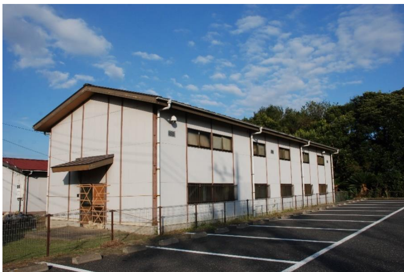
郷土博物館収蔵庫 5 被災状況写真
