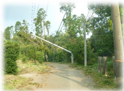
電柱被害（上宮田）
