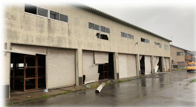
公共施設被害（坂戸市場）
