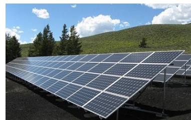
写真 事業用太陽光発電設備
