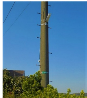
写真 LED設備（防犯灯）
