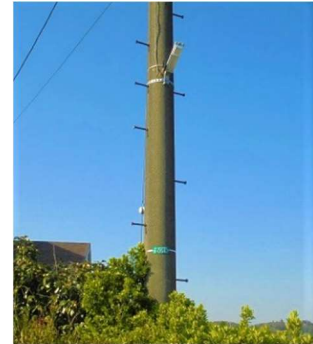
写真 LED設備（防犯灯）
