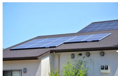
写真 太陽光発電システム
