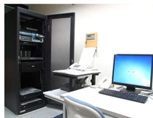
写真 大気環境監視システム
