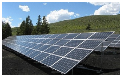
写真 事業用太陽光発電設備
