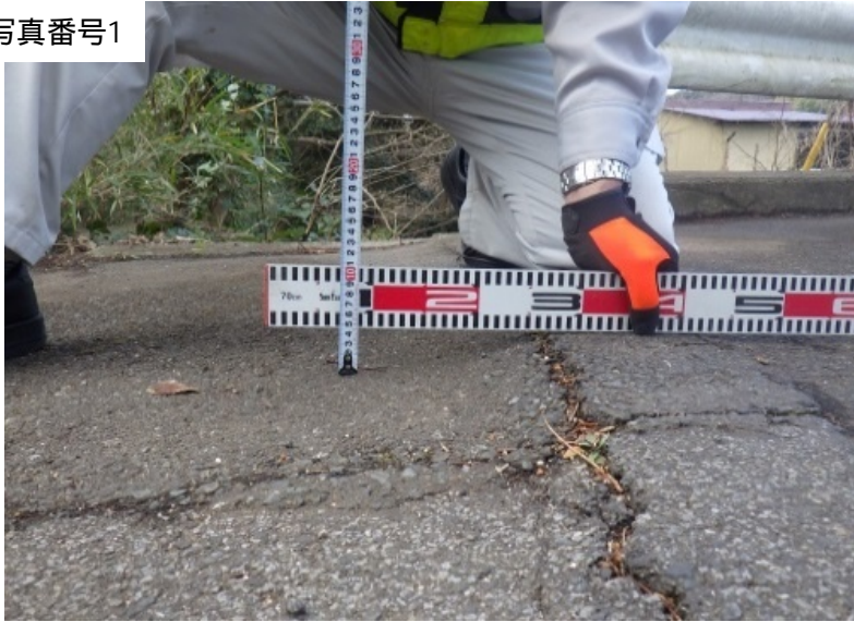
舗装に路面の凹凸が見られる。
