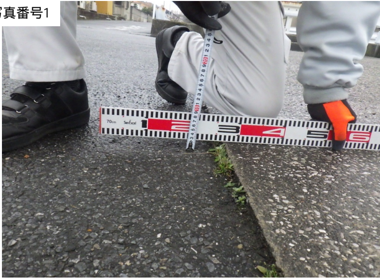
舗装に段差が見られる。
