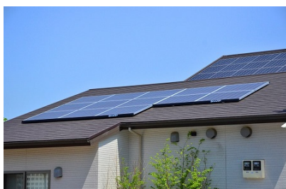
太陽光発電システム（住宅用）
