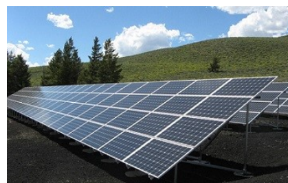
太陽光発電システム（事業用）
