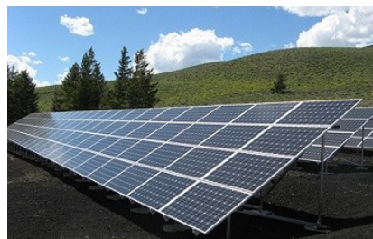
太陽光発電システム（事業用）
