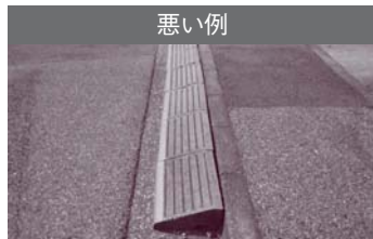
悪い例 ブロックが排水の障害や、歩行者などの転倒事故の原因となります
